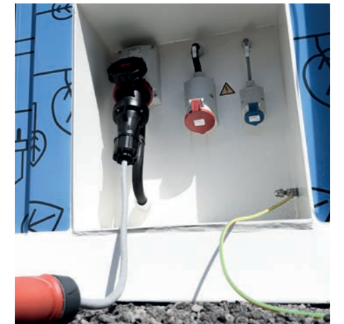
Alles gut zugänglich. Links der 63A-CEE-Eingang. Rechts daneben die 32-A- und 16A-CEE-Ausgänge.
