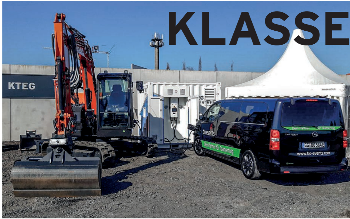
Selbst Elektro-Fahrzeuge können am Powertree Strom tanken.
